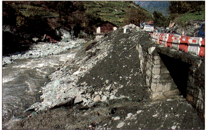
Schadenplatz Neubrück Nord, die Bahntrasse ist nicht mehr sichtbar. Es befand sich unter dem Schuttkegel und der über die Ufer getretenen Vispa.
