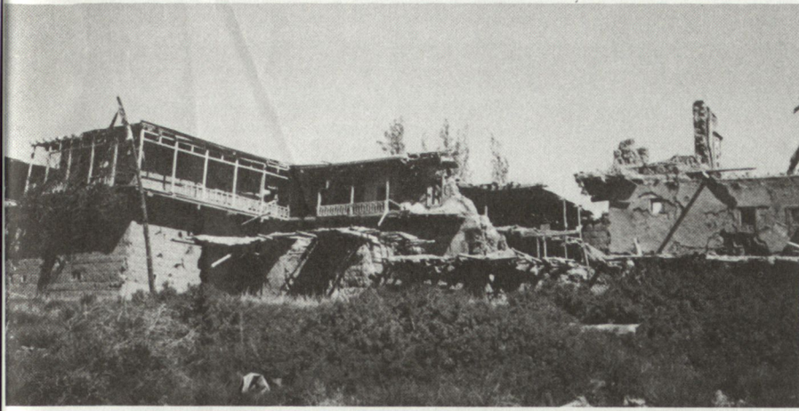
Zerstörtes Gehöft bei Maidan aus Lehmmauern und Holzgebälk. Foto: Qasim Wafa
