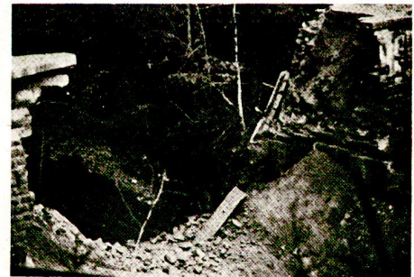
Objekt nach der Sprengung. Deutlich sichtbar die Sandsteinbrocken- und Kieshinterfüllung der Seitenmauern.
