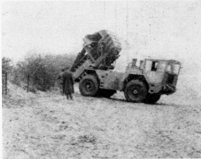
Bild 2. Eine Stunde später kann der Bagger «Matenin» mit seiner Arbeit am bezeichneten Ort beginnen.
