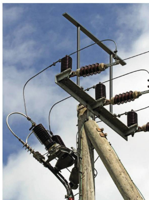
Fig. 36: Protection d'une installation électrique à l'aide d'un perchoir surélevé. Miécourt, 7 mai 2012.
