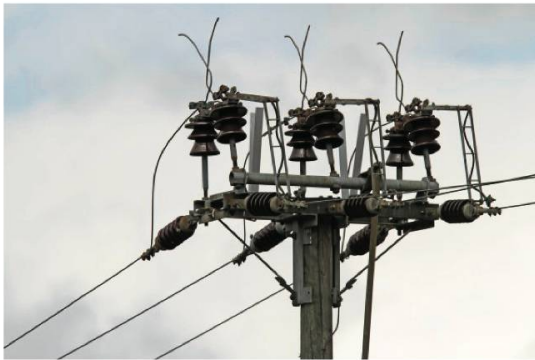
Fig. 30: Interrupteur de courant des BKB FMB Energie SA. Alle, 13 août 2011.
