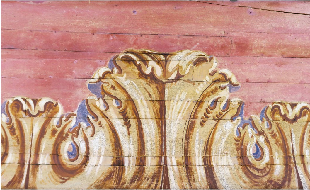
Ill. 16 : Delémont, Café d'Espagne, détail de la corniche après retouche et atténuation des effets de la rouille.
