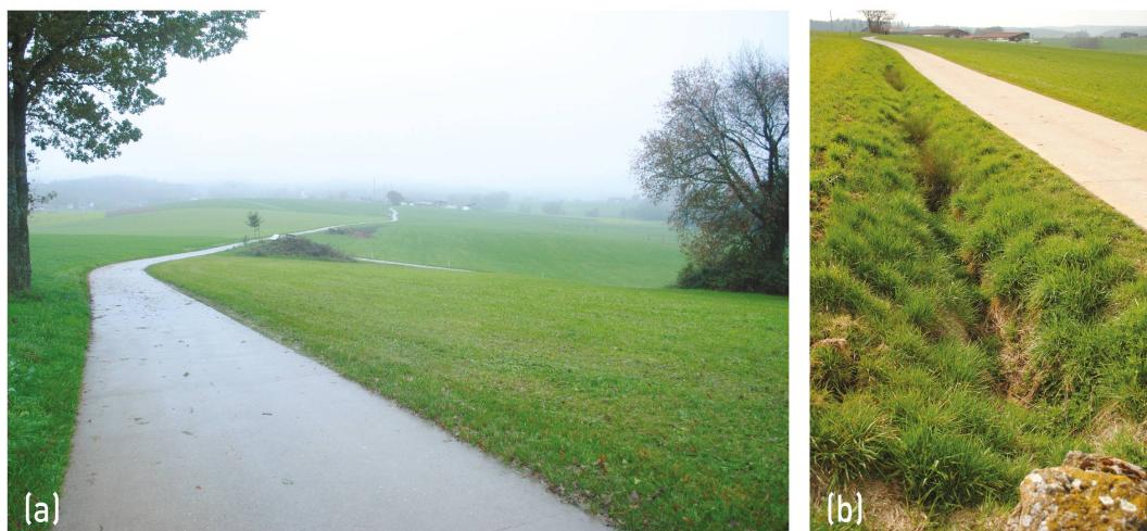
Fig. 10. (a) Le chemin longeant le sud du marais est pentu et fait de dalles en béton sur un coffrage. (b) Sa partie aval est bordée d'un fossé qui collecte les eaux. Les eaux sont redirigées vers le marais par un tuyau sous la route, donc de manière concentrée (cf. figures 5 et 7a).
