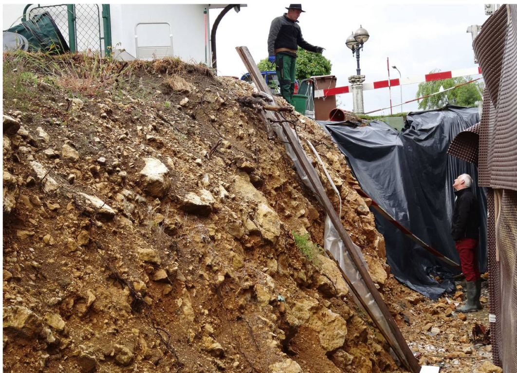
Fig. 8: Talus de la fouille pour le nouvel immeuble à la rue des Vergers (coordonnées 593 515/246 567).
