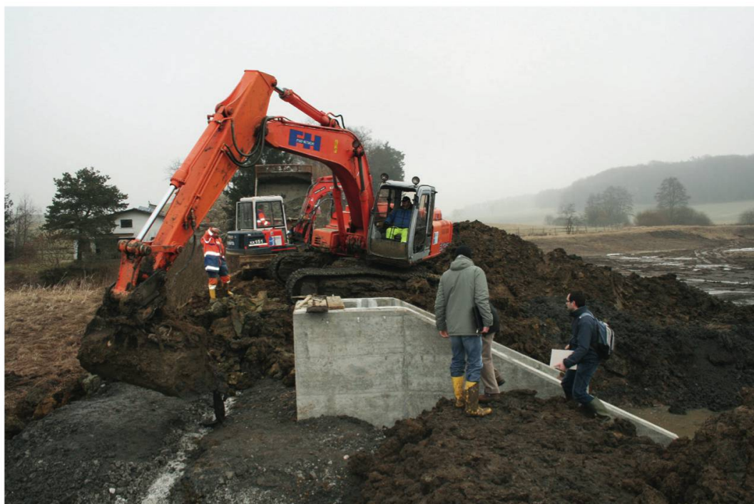
Fig. 3 : Réfection de la digue de l'étang 2, avec un muret en béton maigre noyé dans les marnes à Opalines venant du Mont Terri et la mise en place d'un système de vidange, janvier 2009.
