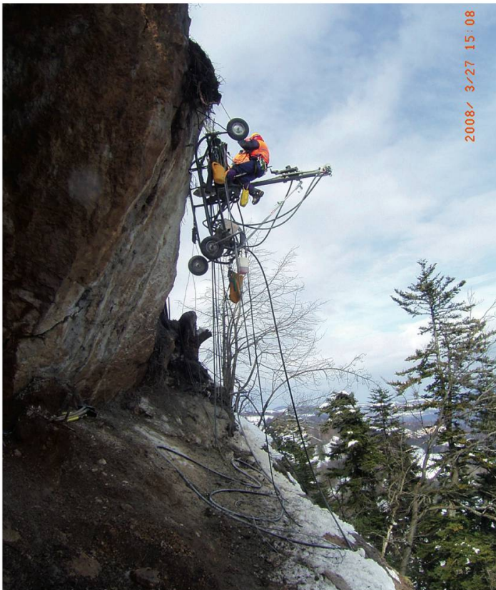
Figure 8: forages pour les clous dans la niche d'arrachement.
