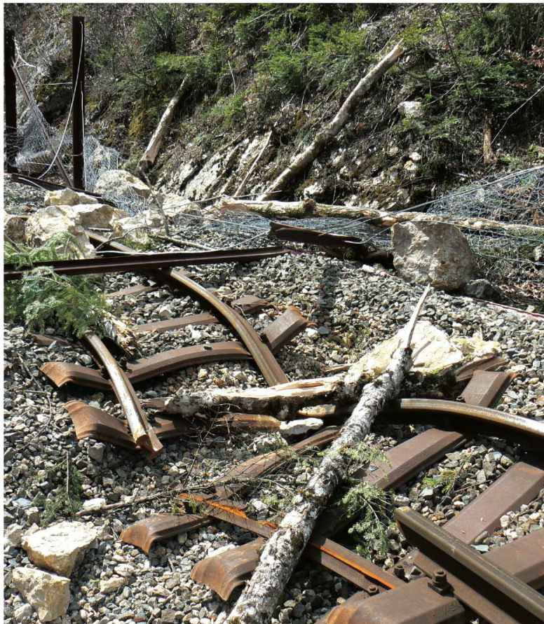
Figure 4: destruction de la voie des Chemins de fer du Jura (CJ).
