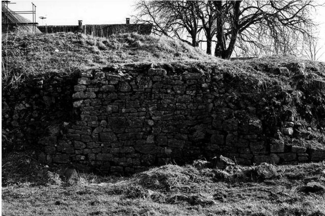
Fig. 5 : Vue du parement extérieur de l'extrémité ouest de l'enceinte avant les restaurations. A gauche, le parement s'est effondré. A droite, on distingue l'amorce de la tour sud-ouest. (Photo: C. de Reynier)
