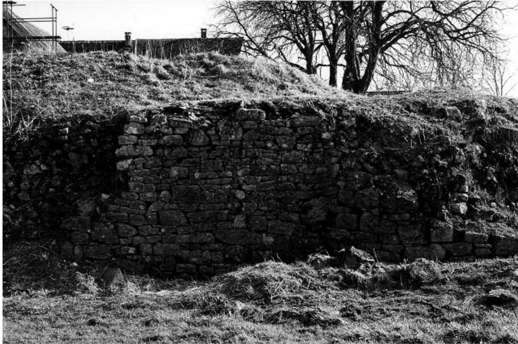
Fig. 5 : Vue du parement extérieur de l'extrémité ouest de l'enceinte avant les restaurations. A gauche, le parement s'est effondré. A droite, on distingue l'amorce de la tour sud-ouest. (Photo: C. de Reynier)
