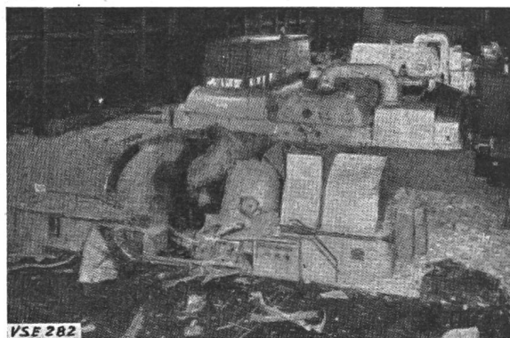
Fig. 1 Salle des machines de la centrale de Ridgeland après l'explosion du groupe turbo-alternateur n° 4 (au premier plan)
