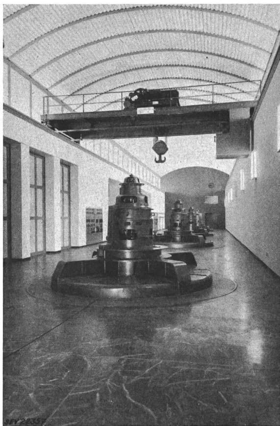
Fig. 7 Maschinenhaus Verbano Maschinensaal
