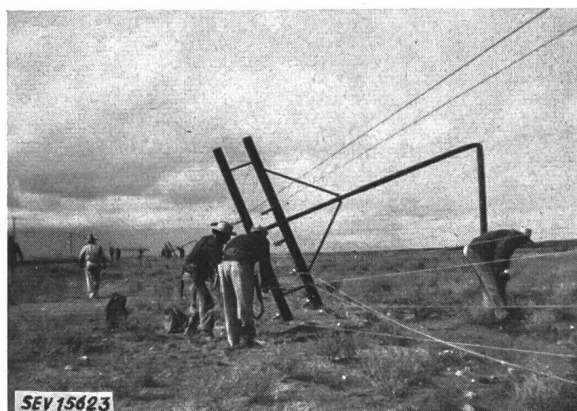
Fig. 9 Ein geknickter Mast
