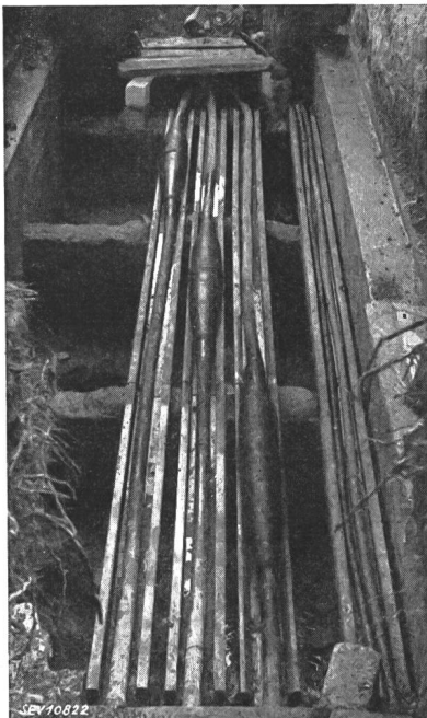
Fig. 5. Muffenschacht der 45-kV-Kabel- leitung
