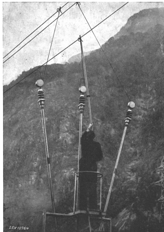
Fig. 3. Die Kontaktzangen werden mit der Schaltstange an die Hochspannungsleitung angehängt
