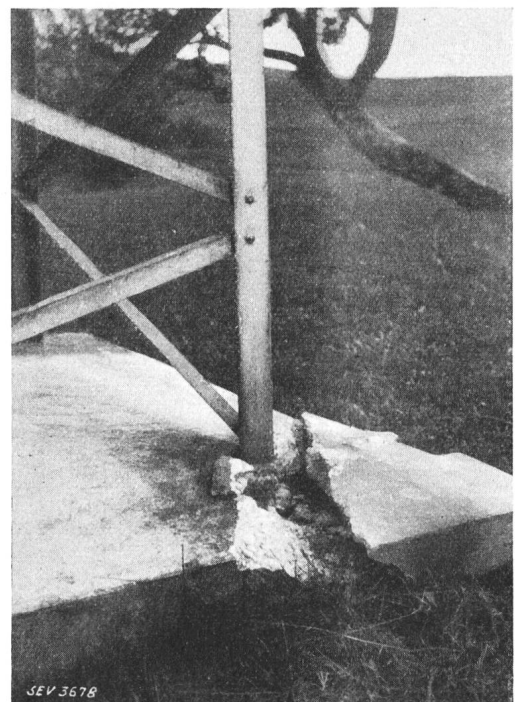
Fig. 24. Vom Blitz beschädigter Beton-Mastsockel, zu Oszillogramm Fig. 23.
