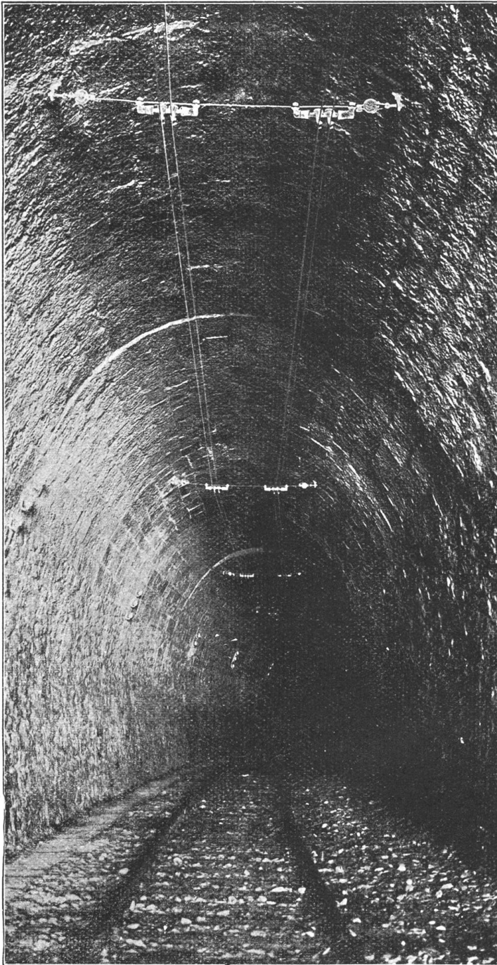
Abb. 14. Anordnung der Kontaktleitung im Tunnel.
