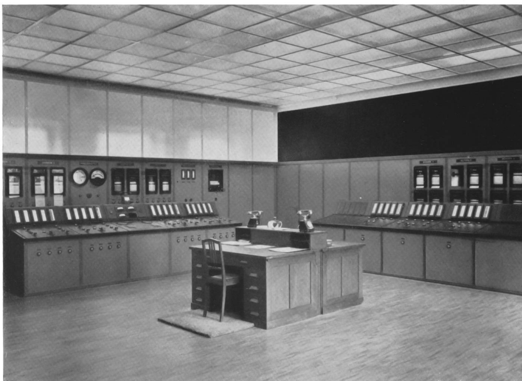
Kommandoraum des Betriebsgebäudes Innertkirchen.
