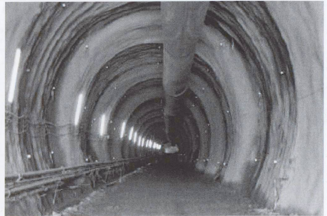
Galleria in materiale sciolto, tubo ovest. Da notare la sagoma «a dente di sega», tipica degli avanzamenti a infilaggi
