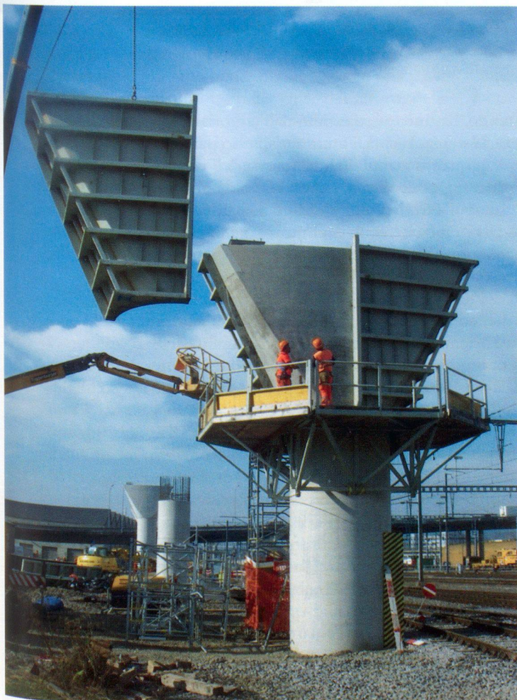
Operazioni di scasseratura del capitello di una pila e, a destra, vista trasversale su pila e sezioni a geometria variabile su pila, capitello e appoggio
