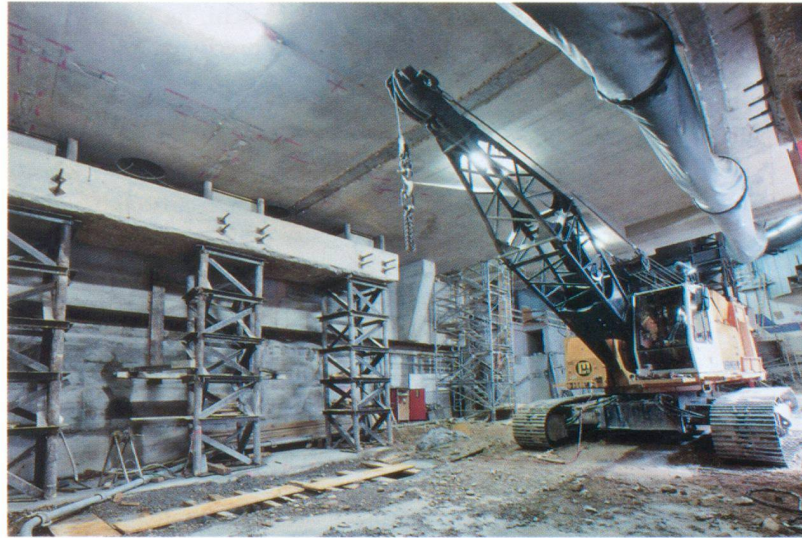
Diaframmi a pali realizzati negli spazi angusti della Querhalle IG ZALO, Poyly Infra AG
