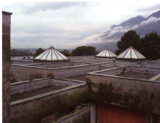
Il degrado dell'edificio esistente prima del risanamento termico/funzionale
