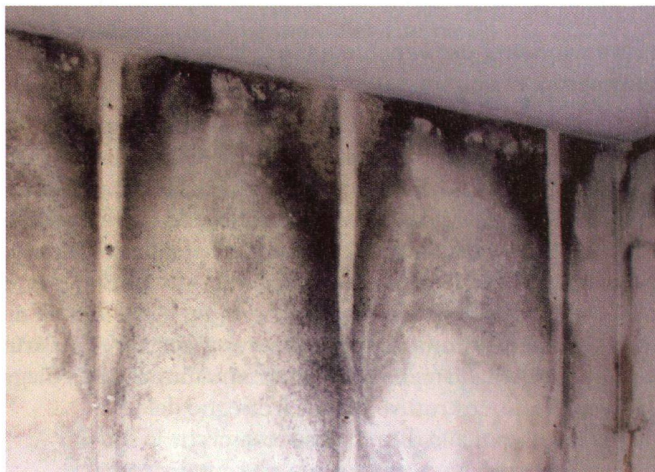
Muffa dietro un rivestimento di parete isolato
