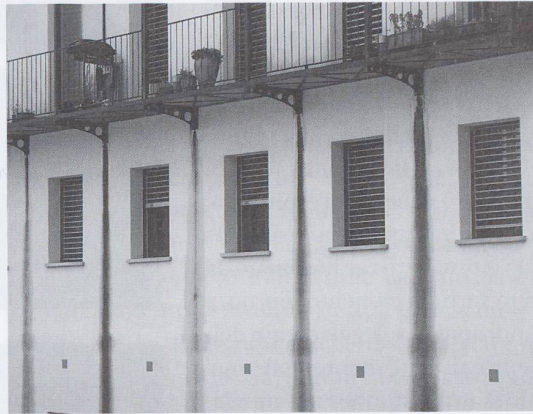
Fig. 2 – Striature verticali scure formate da colonie di microrganismi, il cui sviluppo è dovuto a colature di acqua piovana sulla facciata in corrispondenza degli appoggi del terrazzo
