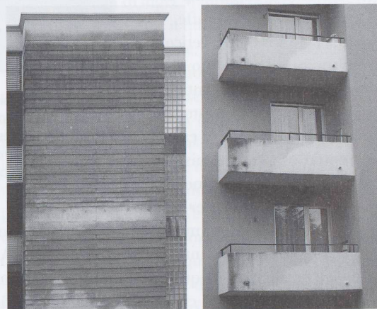
Fig. 3 – Patina biologica su una facciata in calcestruzzo facciavista a seguito di una superficie fortemente strutturata orizzontalmente Fig. 4 – Crescita di alghe sui parapetti dei balconi a seguito di problemi di allontanamento dell'acqua piovana
