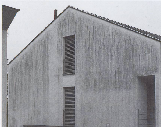
Fig. 1 - Patina biologica su una facciata sprovvista di gronda
