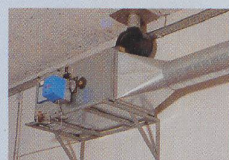
Riscaldamento ad aria calda
