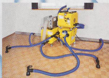
Prosciugamento dei danni dell'acqua
