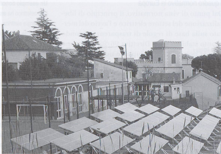
Fig. 3 – Energia fotovoltaica Impianto fotovoltaico di Berteggi (SV, Italia), 30 kW
