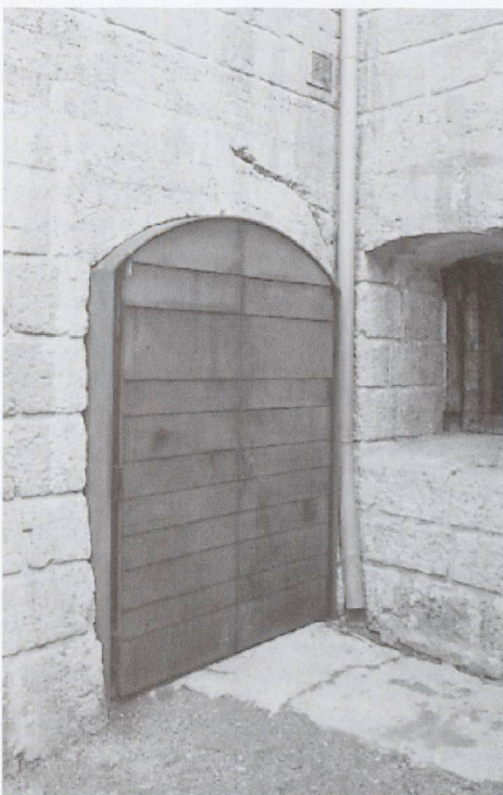
Il nuovo portone di ingresso al Forte (lamiera d'acciaio acidata e profili)
