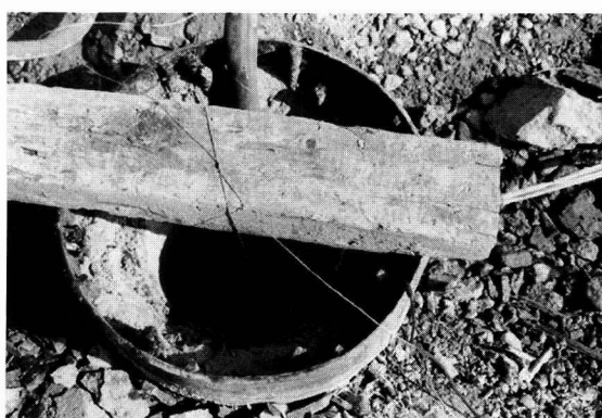
8 — Foto dell'installazione dei sensori in un palo centrifugato a Ennethorw (autostrada N2/6)
