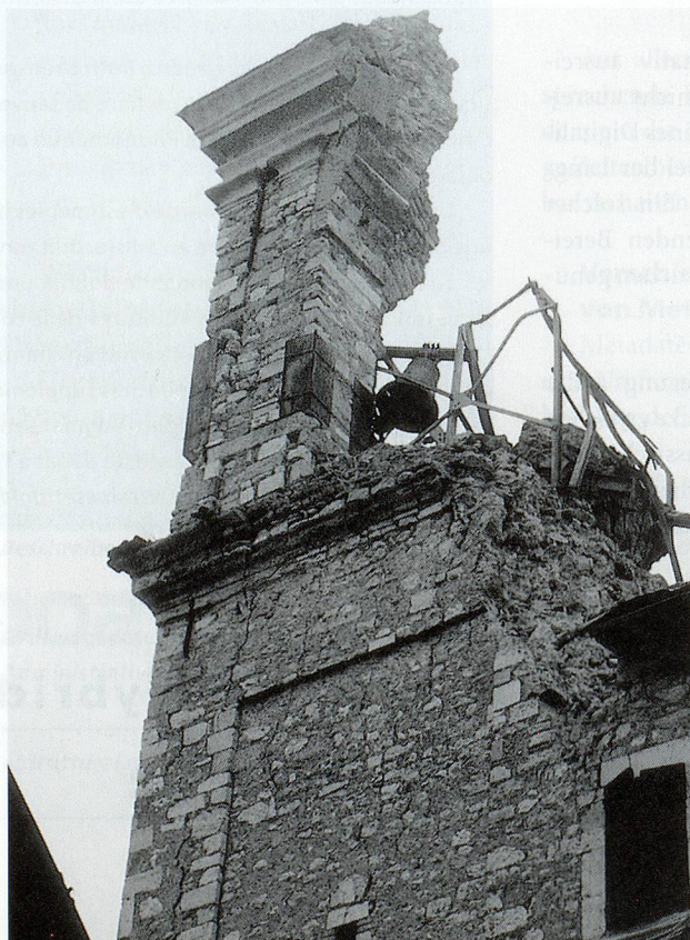
Schaden an einem Kirchturm nach einem Erdbeben in Umbrien, 1997.
