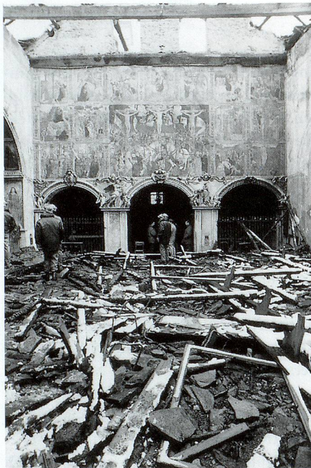
Die Kirche Santa Maria delle Grazie in Bellinzona (TI) wurde durch einen Brand schwer beschädigt. Foto: Consorzio PBC Bellinzona
