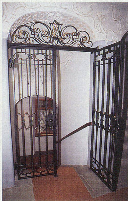
Ein Gittertor trennt das Treppenhaus des Pfarr- und Gemeindehauses am Trogener Landgemeindeplatz von den Räumen der Kantonsbibliothek.
