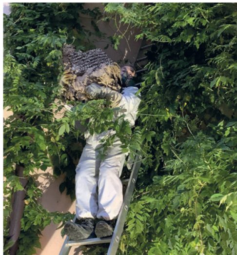
Photo 3. Descente du nid de frelons asiatiques à Bussy-Chardonney (VD), le nid se trouvait sous l'avant-toit d'une maison à 4 m de hauteur (novembre 2023).
