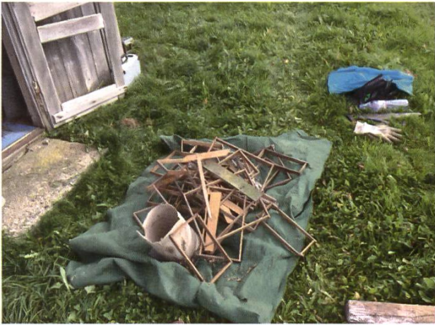
1 re étape: trier et éliminer correctement le matériel obsolète
