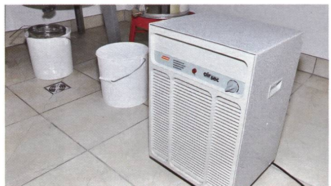
Photo 6 – Un déshumidificateur d'air permet de maintenir l'humidité de l'air à un bas niveau dans la miellerie. (Photo: Ruedi Ritter)
