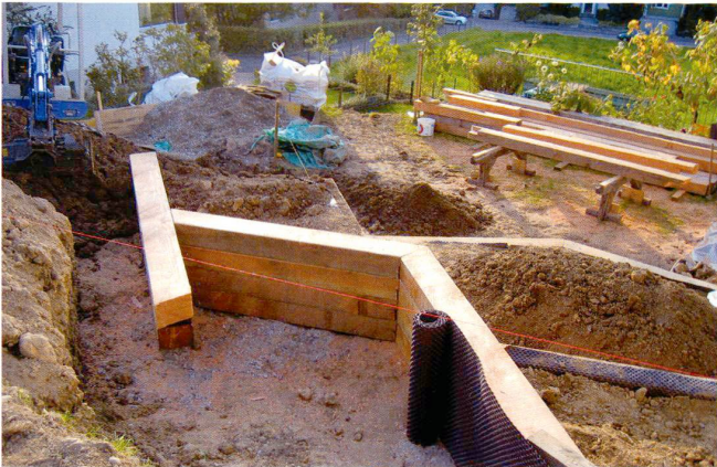
Jeweils vier liegende Douglasienbalken bilden eine Mauerstufe. Quatre poutres en bois de douglas forment une marche.
