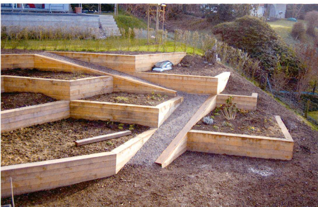
Die Holzmauern kurz nach der Fertigstellung. Les parois en bois peu de temps après leur construction.
