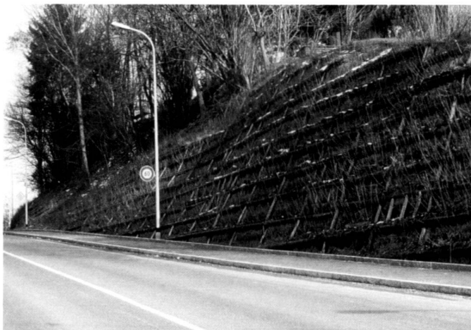
Links: Hangrost als Böschungssicherung.
