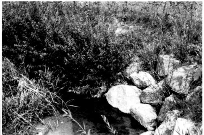
A gauche: Endroit défectueux typique. Talus de prés érodés et affaïsés.
