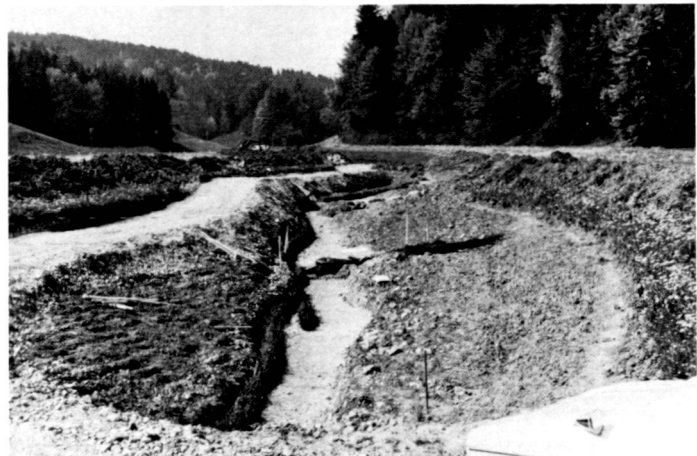
A gauche: Au printemps 1980, lors de la construction de la traverse et du montage des fascines.
