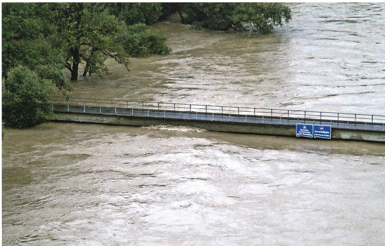
Abb. 13: Hochwasser bei der Brücke Werd vom 23. August 2005, Rottenschwil. (Foto: zVg Abteilung Landschaft und Gewässer, Kanton Aargau)
