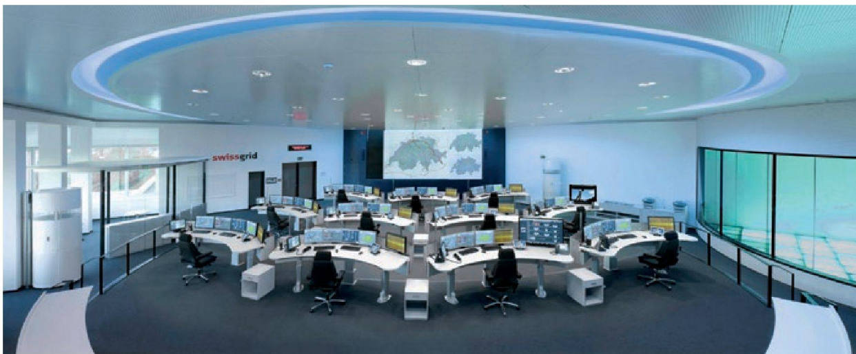
Abb. 11: Swiss Control: moderne Netzleitstelle der Swissgrid in Laufenburg. (Quelle: Swissgrid AG Laufenburg)
