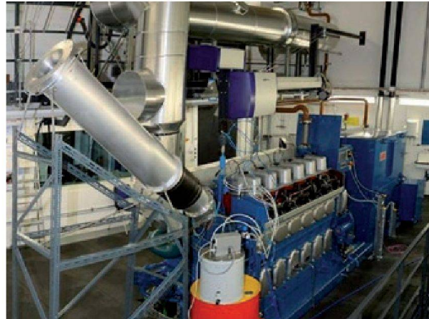
Abb. 23: Teststand mit einem 6-Zylinder Dieselmotor von 1.1 MW Leistung für die Überprüfung von Konzepten zur Reduktion von Emissionen. Bild: PSI.
