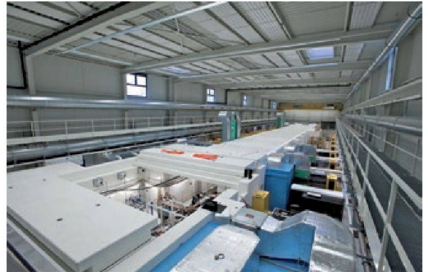
Abb. 39: 60 m lange Testanlage für die erste Beschleunigungsstufe des SwissFEL: Die ersten 20 cm sind entscheidend für die Qualität der 700 m langen Gesamtanlage. Bild: PSI.
