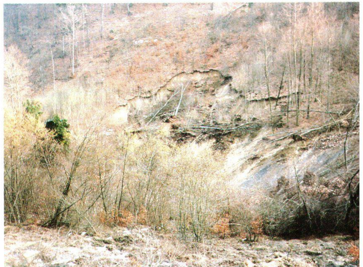
Abb. 12: Hangfusschwächung im Bereich östlich des Felssturzes.
