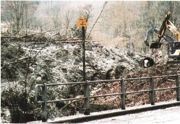
Abb. 15: Schlammfächer im Strassenbereich. Die Arbeiten im Vordergrund verdeutlichen, wie die Eindolung des Fischbaches voranschreitet.
