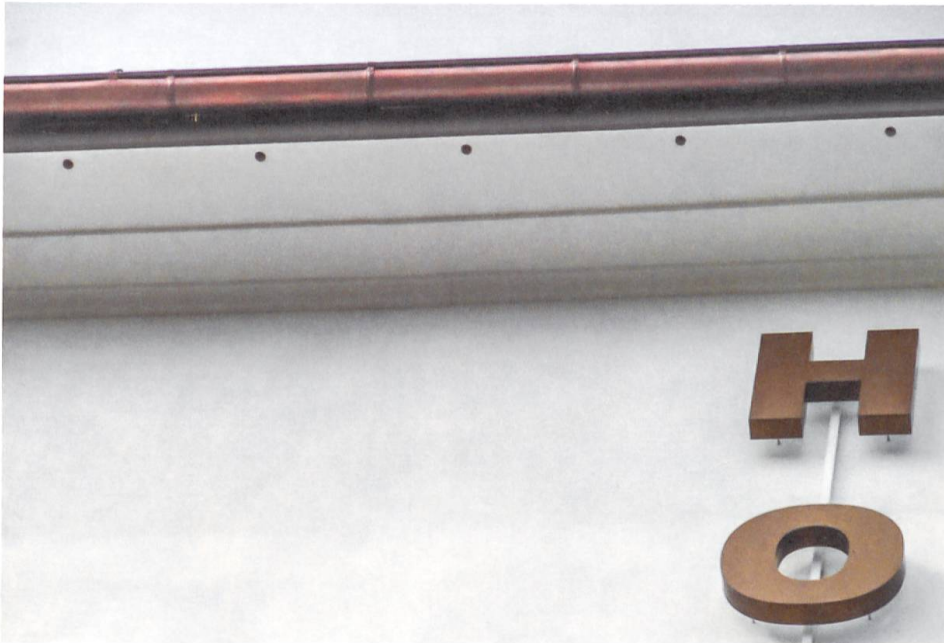
22 Hotel Kettenbrücke, Detail: Über jedem Anflugloch befindet sich ein Nistkasten für Mauersegler. (Foto: Bruno Zeller)
