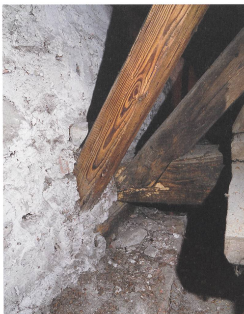
23 Fraubrunnen, Kloster. Dachwerk des Südflügels. Südliche Traufmauer mit 9. Querbundachse von Westen, Ostseite. In der Aufmauerung des 18. Jahrhunderts ist noch ein Stück der Mauerschwelle sichtbar. Sie liegt auf der bauzeitlichen Mauerkrone und trägt den Dachbalken des Querbinders und die Rafen.
