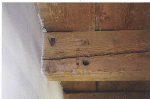
16 Fraubrunnen, Kloster. Westflügel, Teil nördlich der Brandmauer. Deckenbalken des Raumes im ersten Obergeschoss mit Spuren der Verbindung zu Flößen: links typische «Wiedenlöcher» (schräge Bohrung zum Einfädeln der seilartigen «Wieden»).
