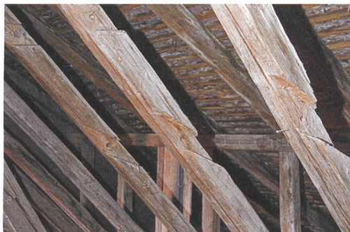
7 Fraubrunnen, Kloster. Dachwerk über dem mittleren Teil des Westflügels, Ostseite. Sparren 5–7 mit offenen Blattsassen und gekerbten Abbundzeichen auf der Südseite.
