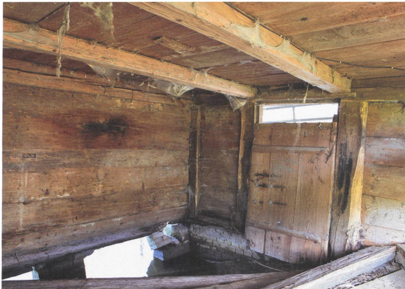
6 Niederönz, Mühlestrasse 37. Der Bretterboden ist aus der Nut gefallen und ins Wasser gestürzt. Die West-Ost-orientierten Deckenbretter werden von zwei Unterzügen gestützt, diesen liegt auf der Nordseite die Laube auf. Blick nach Nordwesten.
