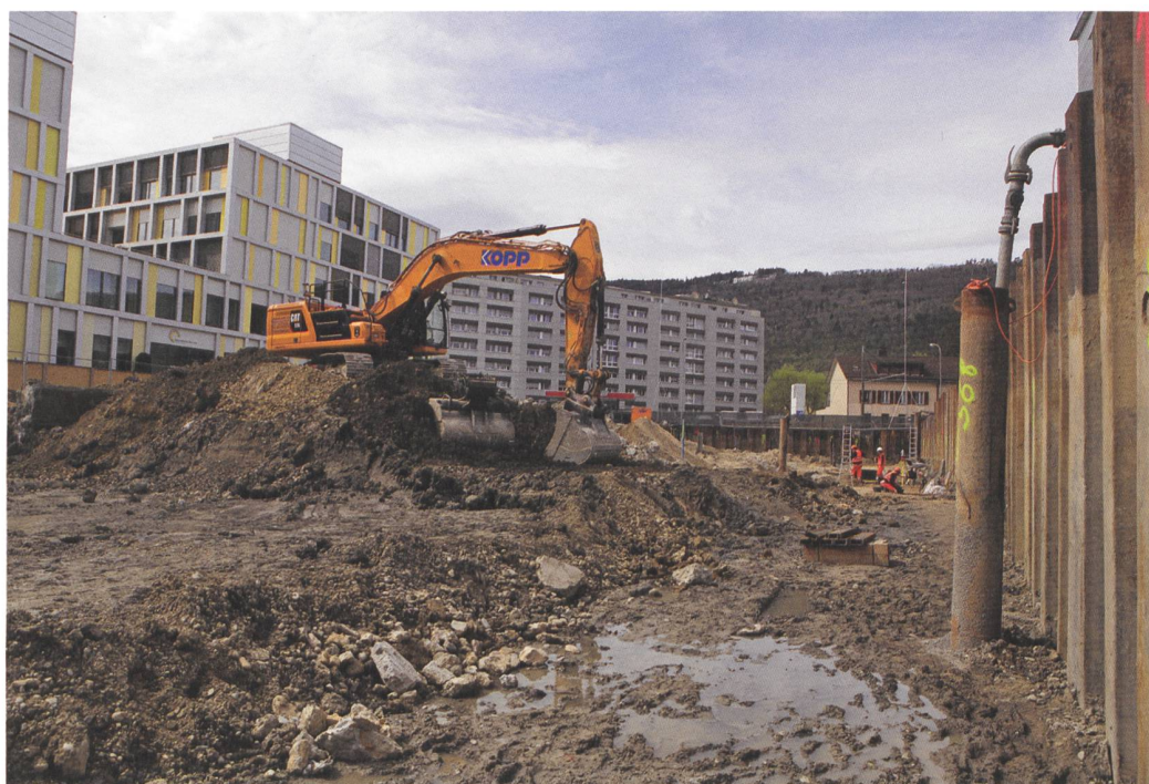
2 Biel/Bienne, Aarbergstrasse 72. Vue d'ensemble du chantier. Vue vers l'ouest. Au premier plan à droite : système de pompe pour l'abaissement du niveau de la nappe phréatique. Au fond : fouille fine et tamisage de la base de la couche position 9.
