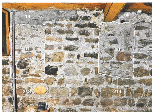
7 Saanen, Tüllerliweg 3. Keller 2: Mauer 6 (Abb. 6a) mit horizontalen Fugenstrichen und Brandspuren an den Mauersteinen sowie den im 17. Jahrhundert zugemauerten Schlitzfenstern 10 und 11. Blick nach Westen.
