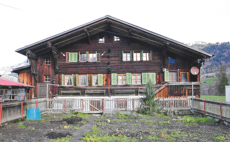
3 Saanen, Rübeldorfstrasse 112. Südfassade. Rot: Links und rechts der linken Fensterreihe im zweiten Wohngeschoss sind die bauzeitlichen Fensterpfosten der Kammern zu erkennen. Blick nach Norden. Zustand April 2023.
