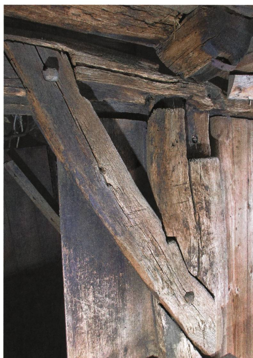
Abb. 2: Thunstetten, Kirchgasse 36. Oberer Abschnitt des südöstlichen Hochständers mit schön geschnittenem Kopfband aus Eiche der Zeit um 1480.
