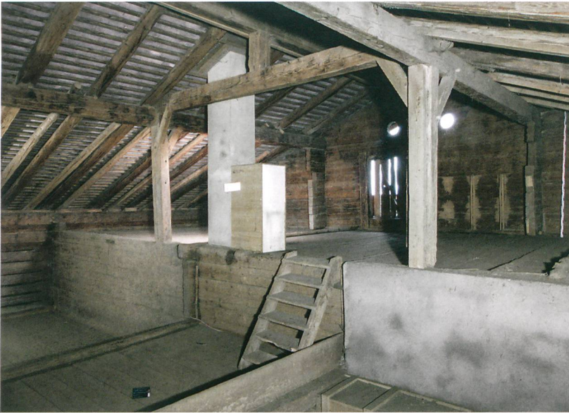
Abb. 6: Thun, Goldiwil, Matthauserweg 23. Dachraum hinter der Giebelwand mit stehender Dachstuhlkonstruktion. Links im Bild ist die Gimmwand mit der Gadenwand überkämmt. Blick nach Südwesten.
